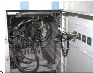
A MAGR installed in Av Bay 3B
